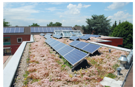
(9) SolarGrünDach. Leistungssteigerung der Photovoltaikanlage durch die Kühlleistung der Dachbegrünung
